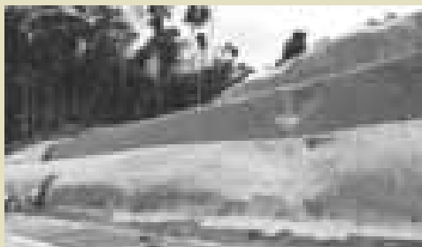
Mantas de yute en taludes de corte Fuente: DOMUS Consultoría Ambiental S.A.C.
