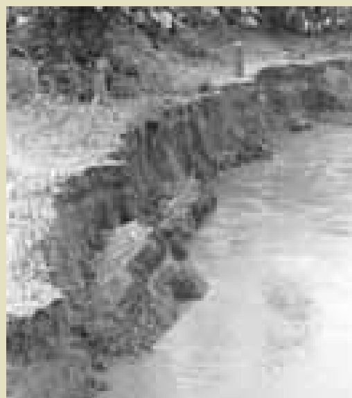
Ribera socavada en Bangladesh, generando desplome del talud ribere6o y ensanchando el cauce y llanura de inundaci6n Fuente: Reuters e-Ince Media
