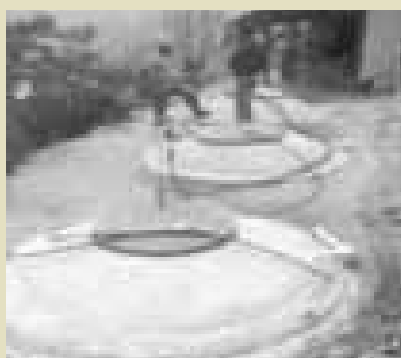
Cisternas de almacenamiento del agua cosechada Fuente: Practical Action
