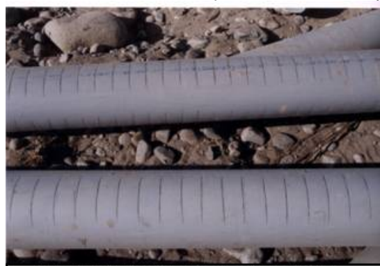
Foto Nº 3: Tuberías ubicadas en las galerías filtrantes de
